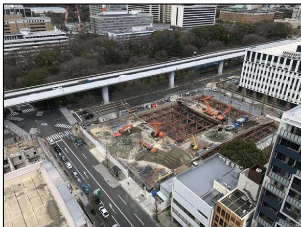
写真 3-2-3-1(3) 名城変電所（全景）
