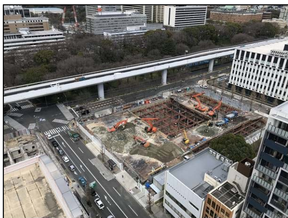
写真 3-2-3-1(3) 名城変電所（全景）
